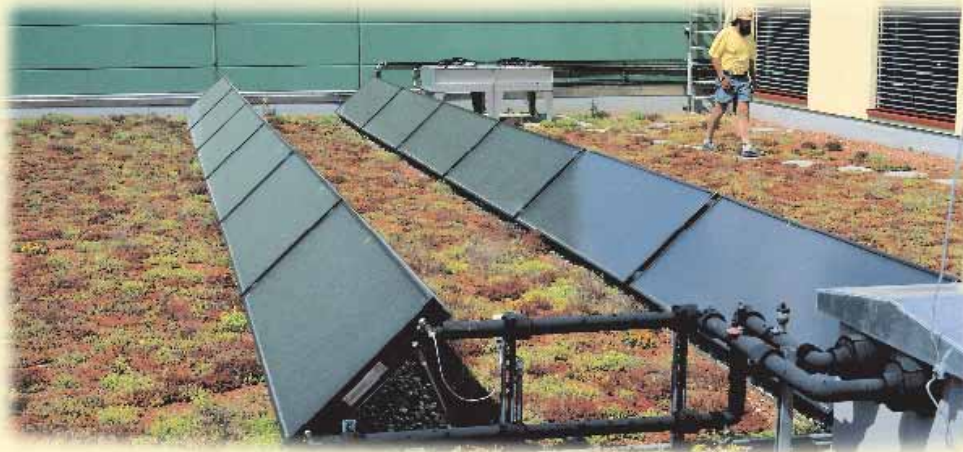
Solarthermie-Anlage auf dem Dach der Ensinger Mineralquellen
